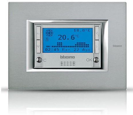
Heizungssteuerzentrale von Legrand. / Foto: Unternehmen
